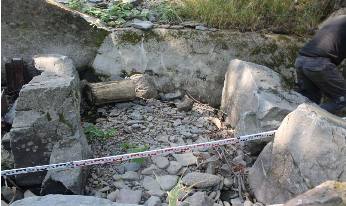
Bild 07 Riegel 3 und 4; Störsteine verschoben und teilweise herausgerissen
