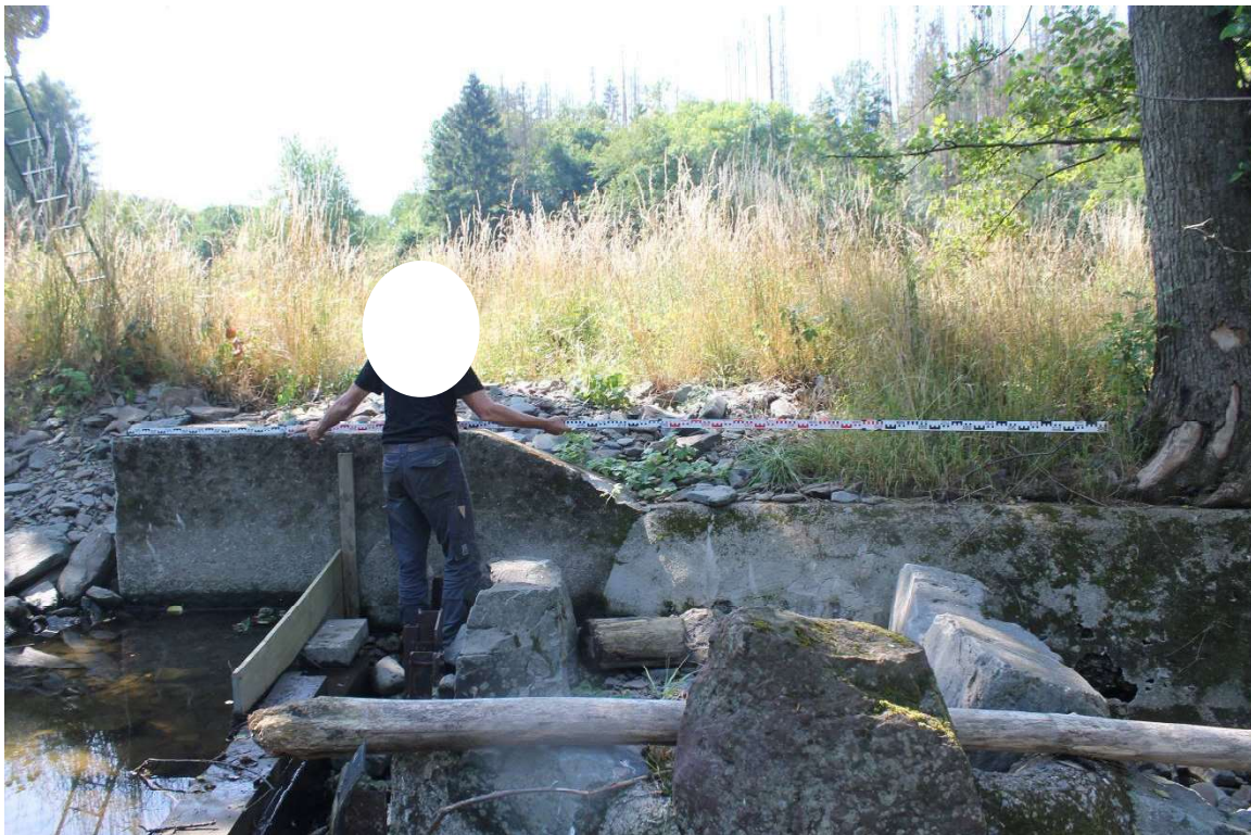
Bild 08 stark beschädigte linke Ufereinfassung, FAA komplett verlandet
