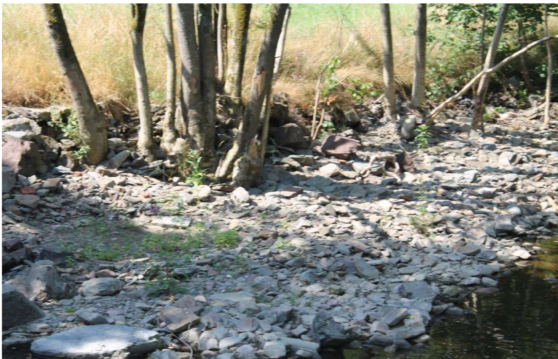
Bild 06 unterwasserseitiger Einstieg, nicht mehr vorhanden und Bereich stark verlandet
