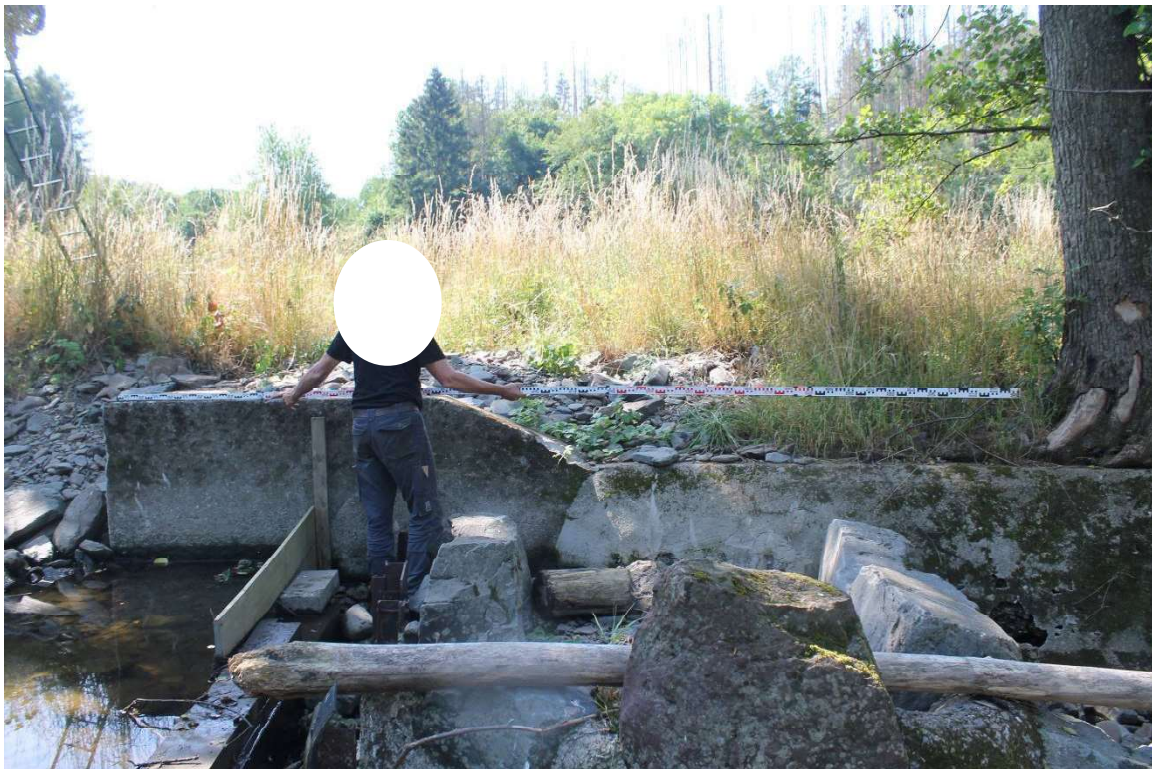
Bild 08 stark beschädigte linke Ufereinfassung, FAA komplett verlandet
