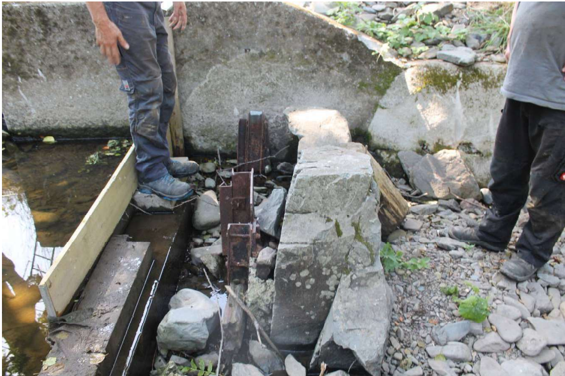
Bild 04 Einlaufbereich (oberwasserseitiger Ausstieg) der FAA nach dem Hochwasser
