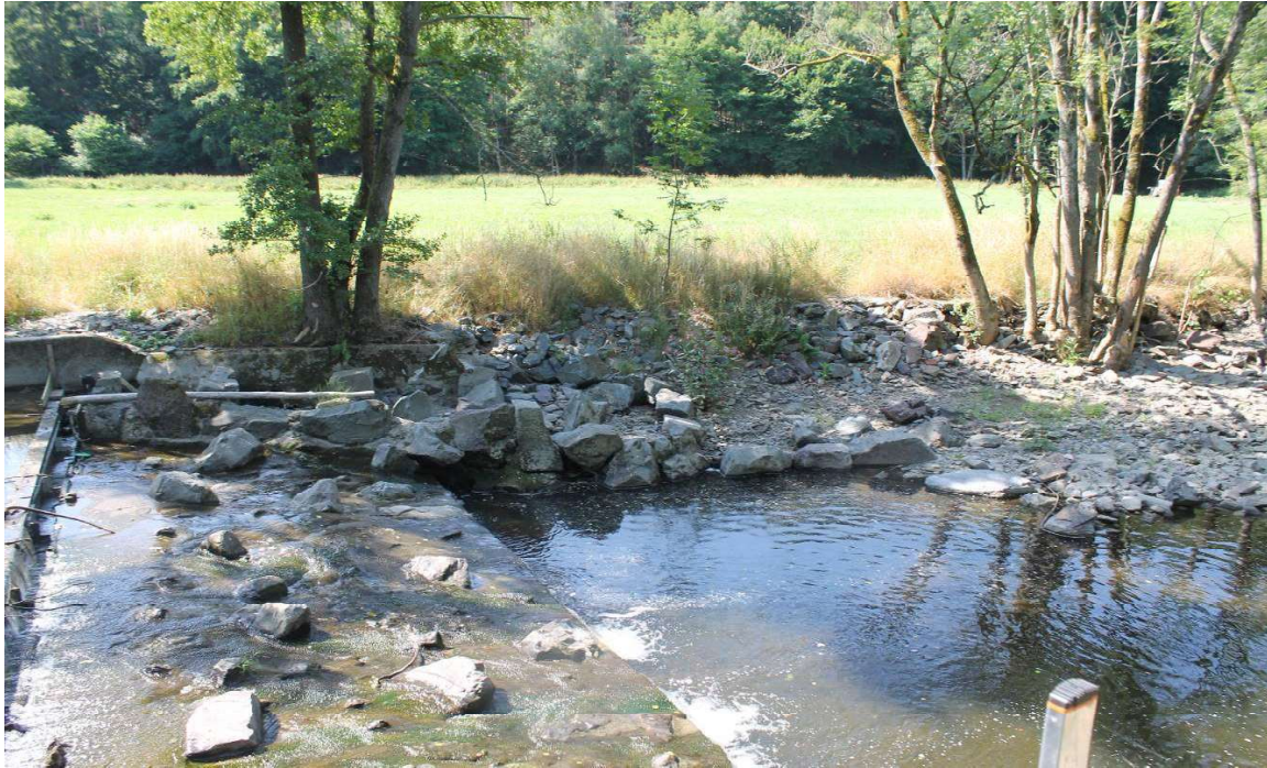
Bild 05 Seitenansicht FAA, unterer Bereich stark beschädigt / teilweise weggespült
